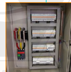
SDP (Sub Distribution Panel)
