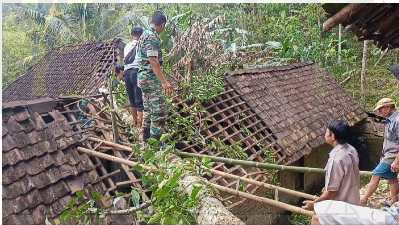
Gambar 1. 14 Rumah tinggal yang rusak akibat pohon tumbang saat bencana alam Sumber: Dokumentasi BPBD Gunungkidul
